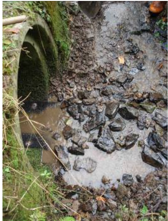
Vue sur l'obstacle après fixation du géotextile et suppression de la chute.
