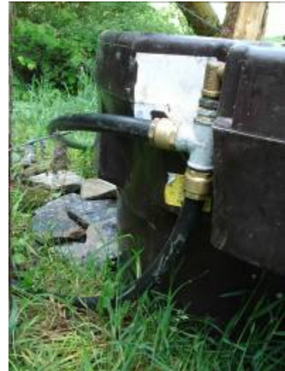
"Pièce T" qui permet également d'alimenter l'abreuvoir situé plus en aval.
